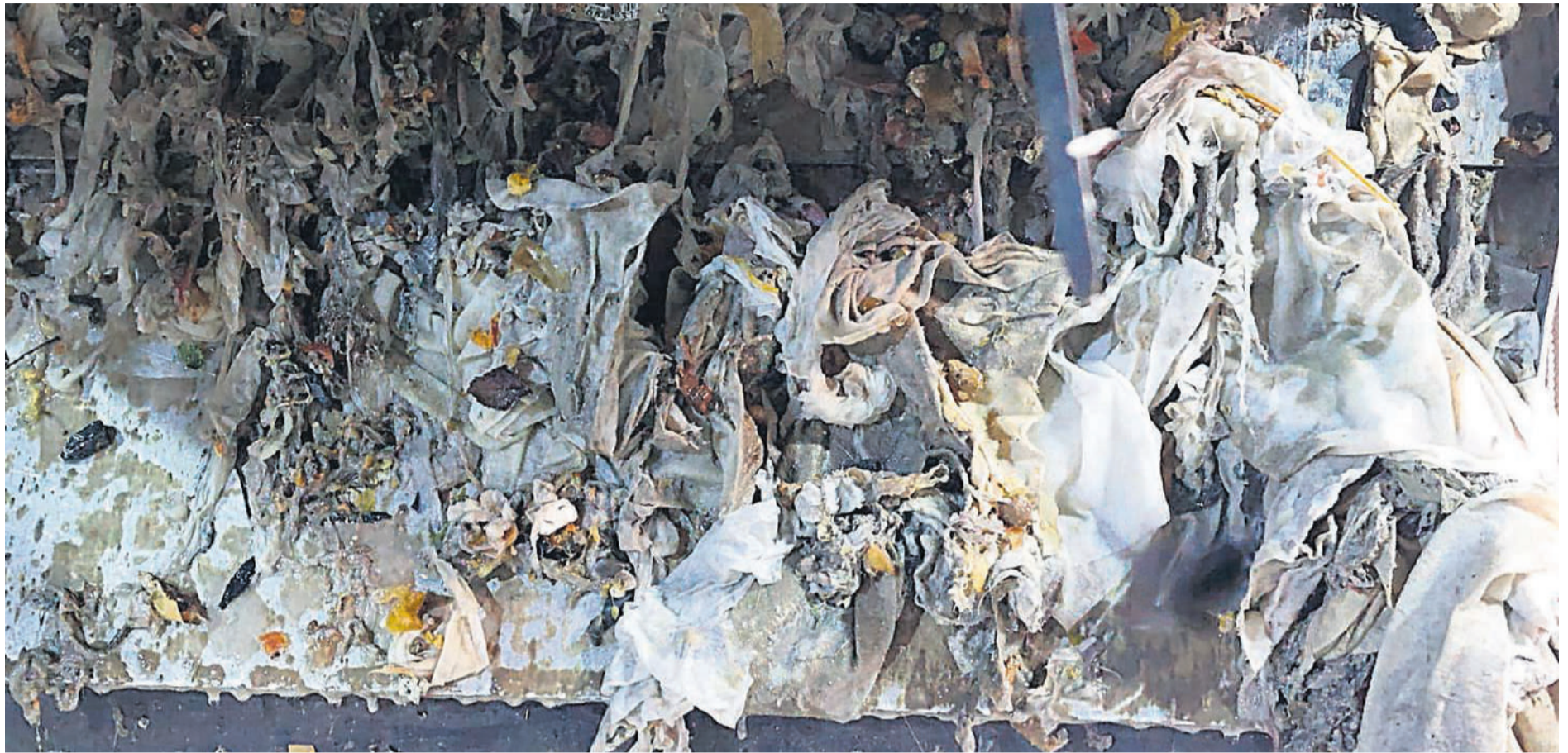
Casi 3 toneladas diarias de toallitas higiénicas son extraídas de la EDAR. A pesar de las mejoras implantadas para poder extraerlas de forma previa a la depuración de estas aguas residuales, este residuo continúa siendo un caballo de batalla del saneamiento. ACEMSA
